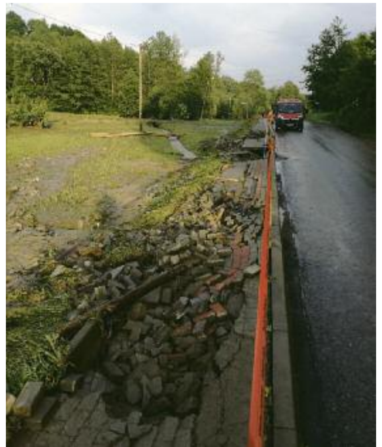
Tak po zeszłorocznych, gwałtownych opadach deszczu wyglądała droga powiatowa Nr 1425R i chodnik.
